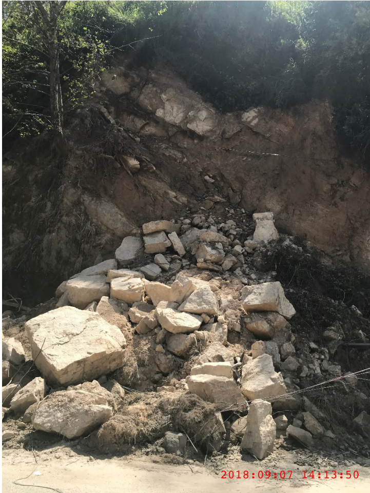
Figure A-19: Rock fall @ 10.0835676° N 77.0615970° E
